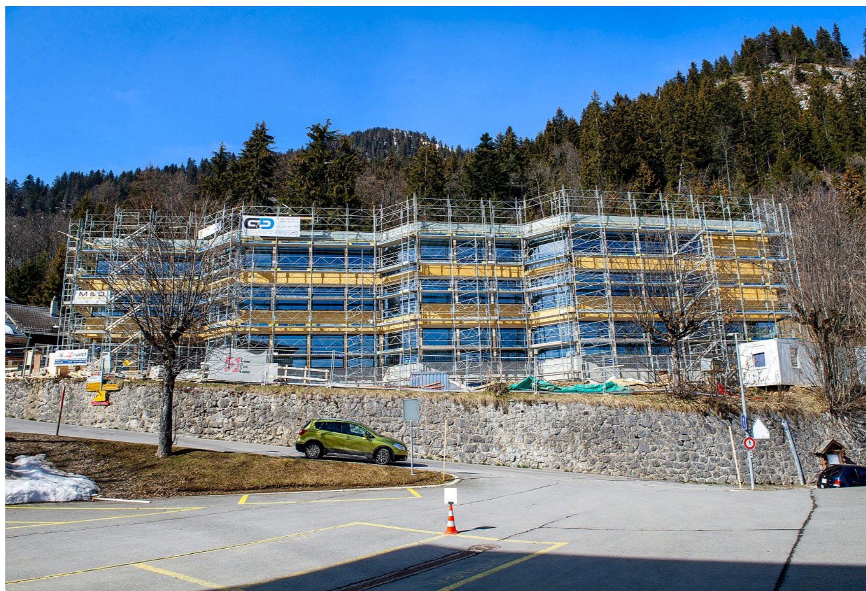
L'activité de construction est importante dans les régions de montagne (ici à Leysin). On note toutefois que les projets sont beaucoup plus nombreux en Valais que dans le canton de Vaud. VANESSA CARDOSO
